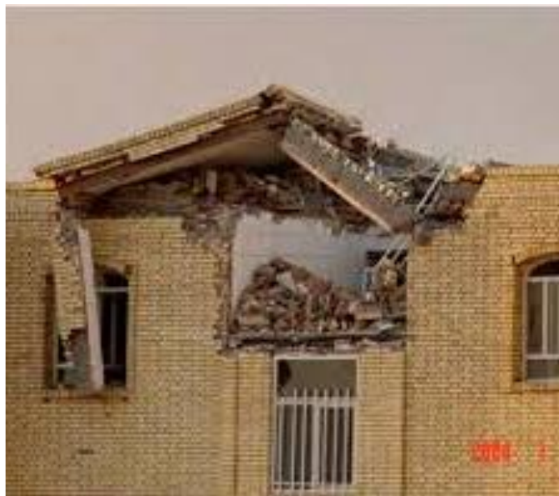
تصویر شماره ۳-۱۲: فرآبی فرپشته در اثر زلزله
