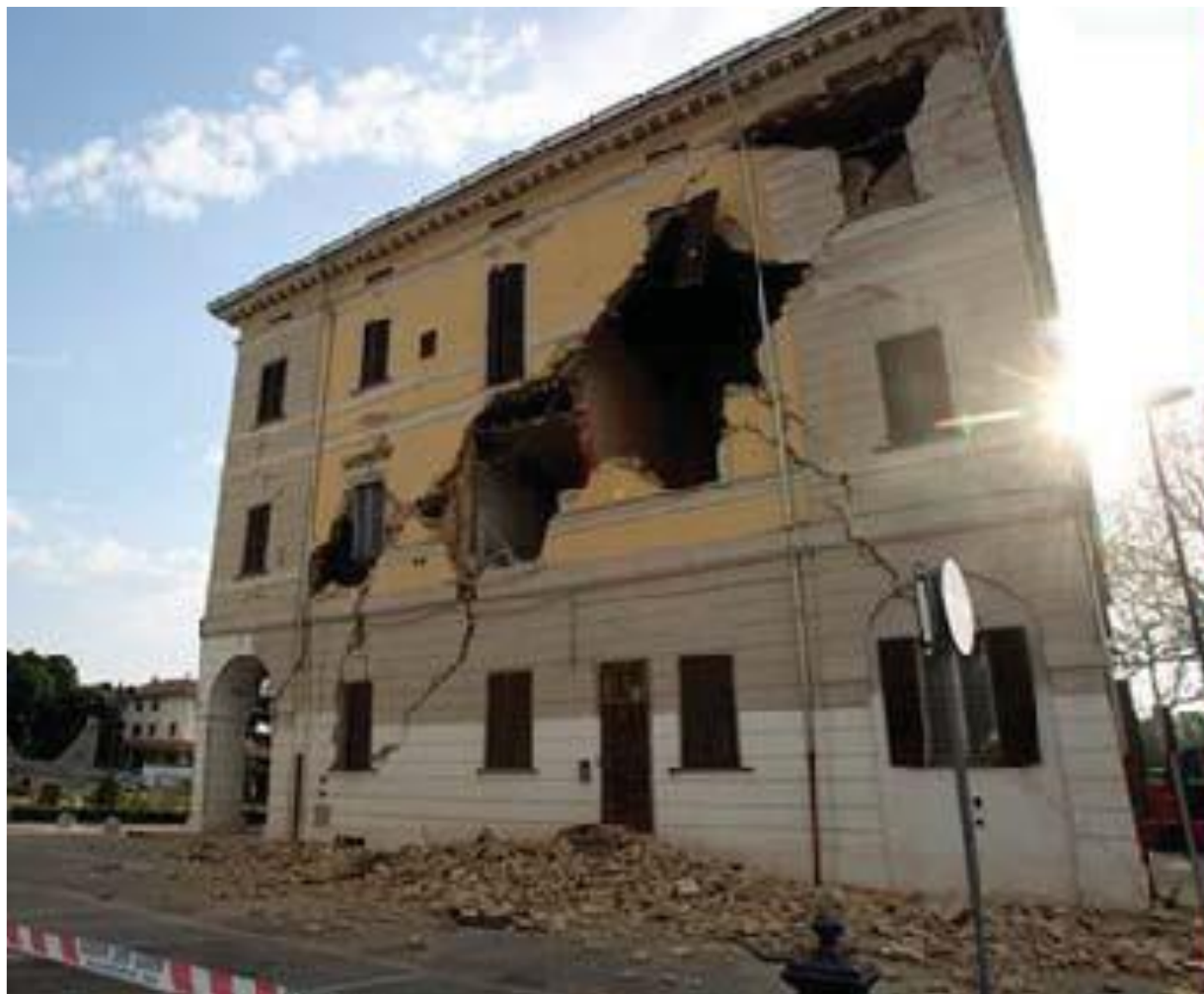
تصویر شماره ۴-۲: تفریب خارج از صفحه دیوارهای بنایی غیر مسلح در زلزله‌های امیلیا - نشریه ۷۲۹
